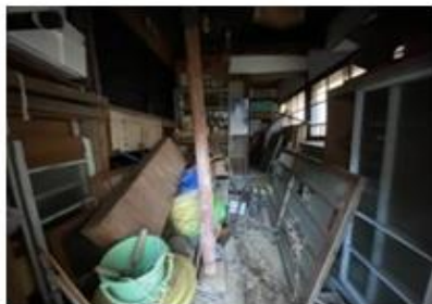
モノが放置された空き家
